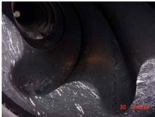
Figure (III.5) : Les fissures (cracking) de l'élastomère.
