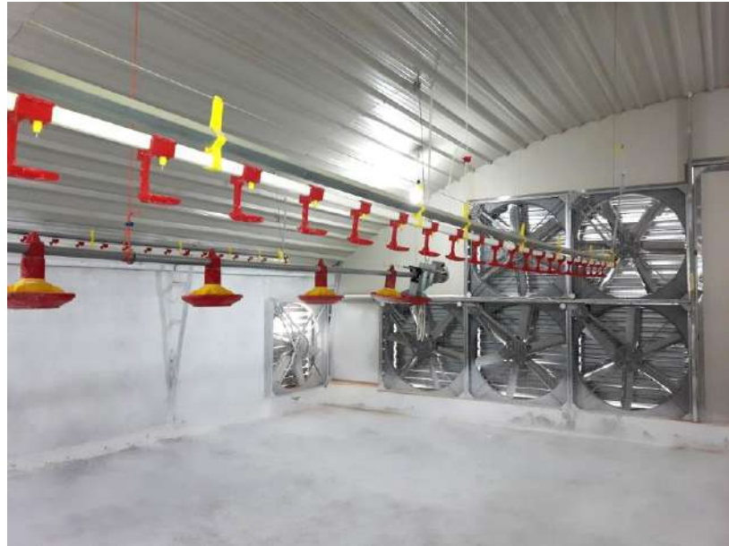
Figure 17: Ventilation dynamique en élevage moderne.
