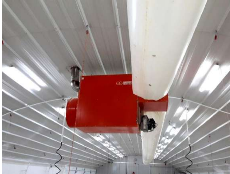
Figure 13 : Générateur d'ambiance (chaudière) chez BAYAT .
