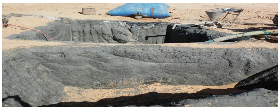
Fig.32 : les bassins de décantation à boue
