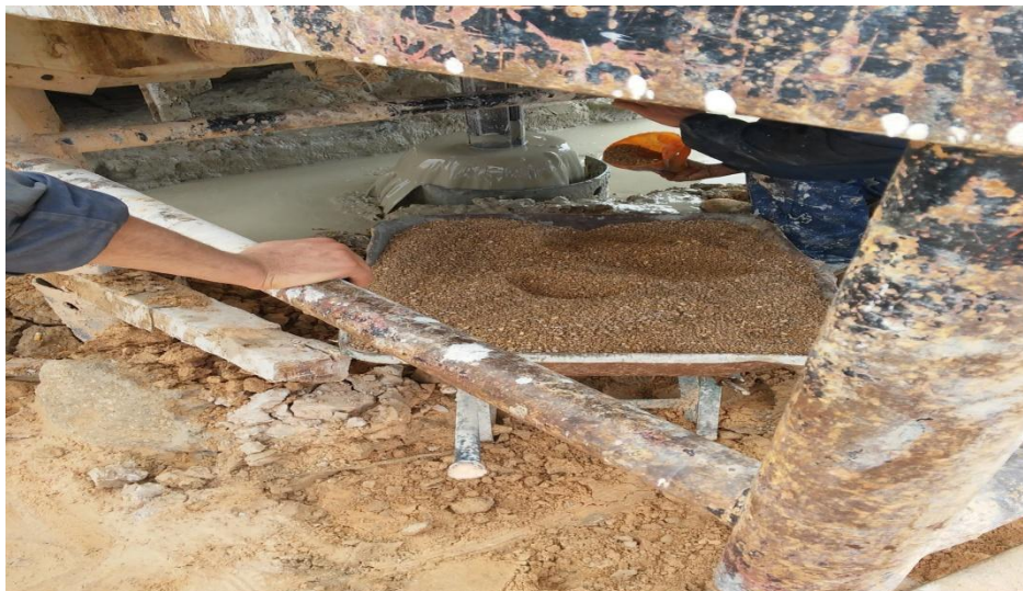
Fig.45 : Massif filtrant (gravie additionnel)
