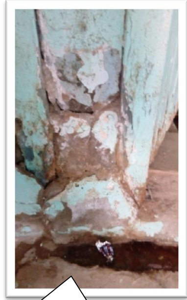
الصورة رقم (11-II): تآكل الجدران و ملاط
