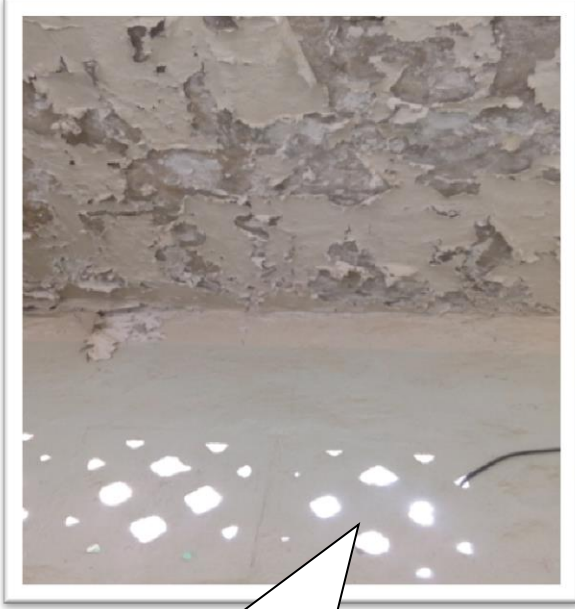
الصورة رقم (8-II): تآكل الملاط
