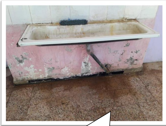
الصورة رقم (10-II): تلف المركبات الصحية بدورة مياه مدرسة لعفو محمد الشريف لاسيليس
