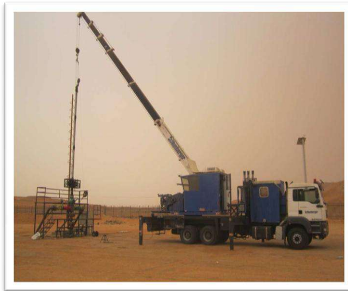
Figure IV.1 Unité de Wire Line sur un puits
