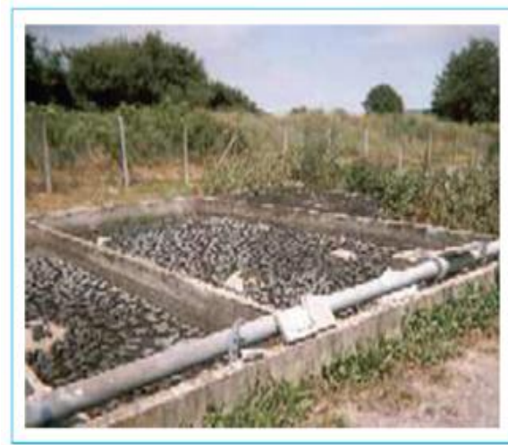
Figure I.4 :Boues sèches sur lits de séchage
