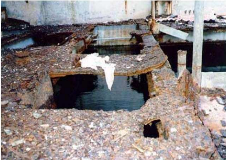
الصورة (4.1) توضح الحالة المتدهورة لمنشأ بسبب التآكل
