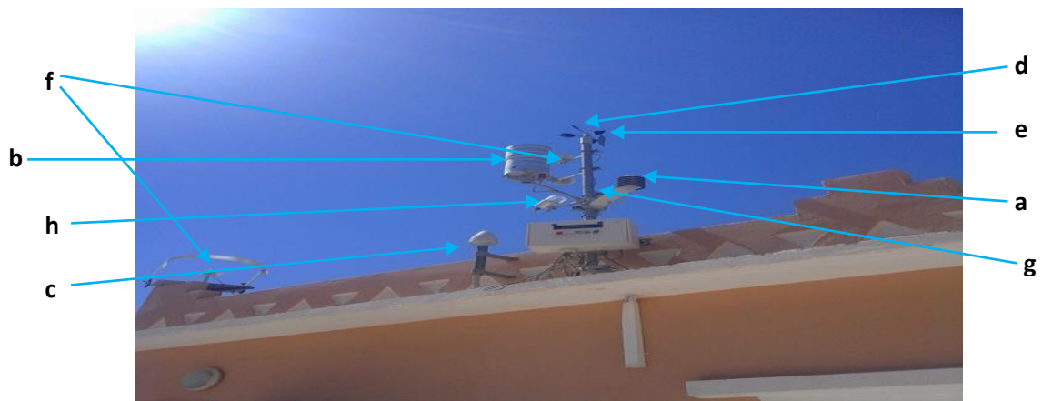
Figure I-7 : Station métrologie installer dans la centrale PV à Ghardaïa.
