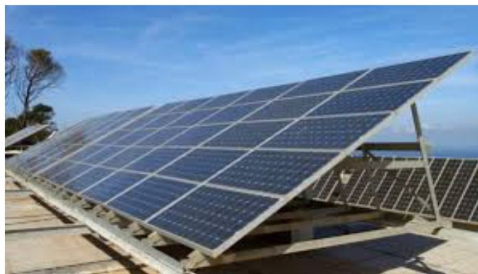
Figure I-18 : Centrale solaire d'El Hadjira
