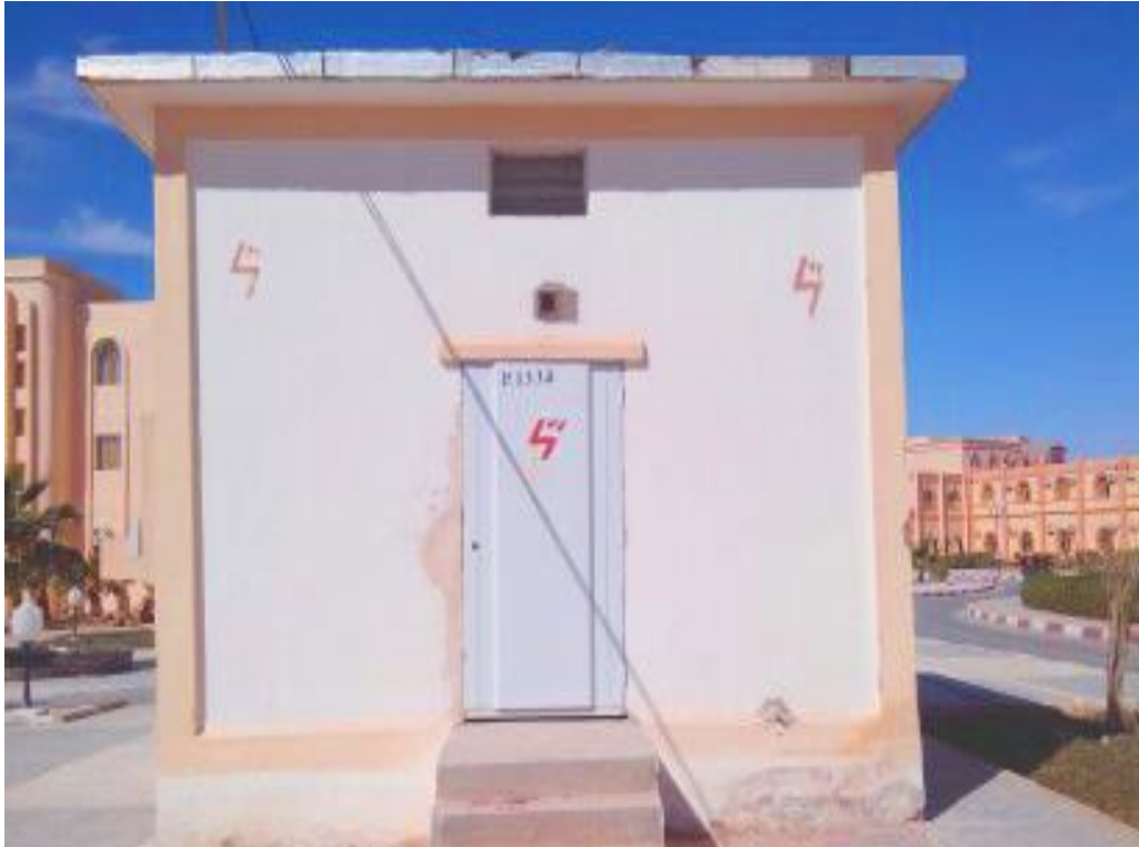
Fig. I.5. Poste en cabine maçonnée.
