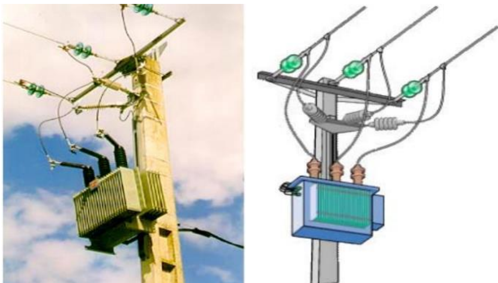
Fig. I.6. Poste aérien sur poteau ou pylône.
