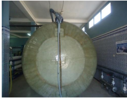
خزان المياه المعالجة
