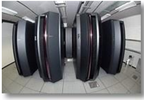
Figure3.4 : Exemple d'un Datacenter
