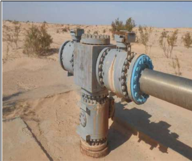
Photo n° 25: forage albien sans abri
