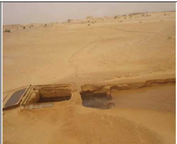
Phot n° 40 : fuite dans une niche du réseau d'irrigation de khchem Erih II
