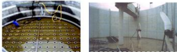
Figure 2-1 : photographie de diffuseurs à fines bulles situés au fond d'un bassin de traitement .
