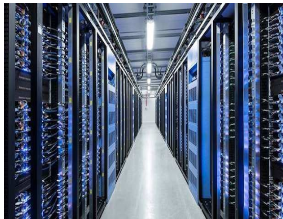
Figure 1.10: Exemple d'un Centre des données [43]
