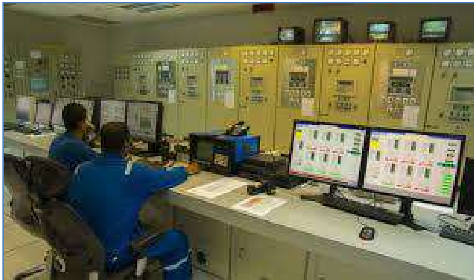
Fig. 1.4. Poste de pilotage d'une supervision (salle de contrôle)
