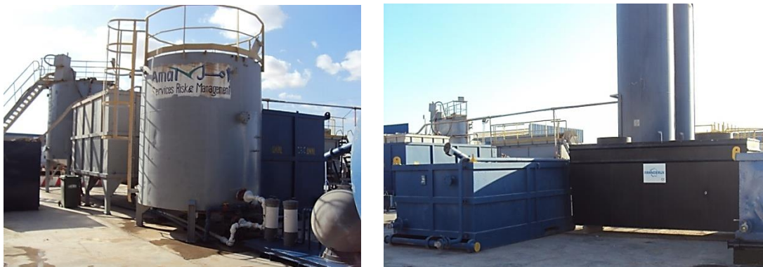
Fig.37. équipements de traitement des déchets fluide à la base. [32]
