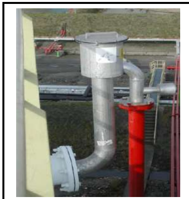
Figure 1.22 : Chambres à mousse positionnées en haut d'un bac
