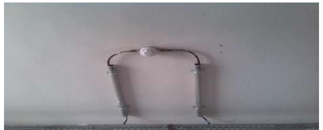
Figure 2.9 : DETECTEURS DE GAZ
