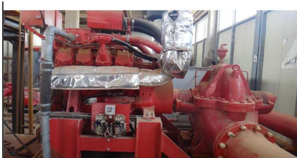
Figure 2.15 :01 Pompe de secours (diesels), GA202, de capacité unitaire de 800m 3 /h démarrage automatiquement, à 07 bars
