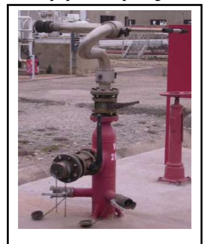
Figure 1.17 : Lance monitor eau montée sur un poteau
