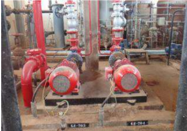
Figure 2.13 :02 Pompes de pressurisation du réseau, type Jockey (GA203 / GA204), de capacité unitaire de 45 m 3 /h chacune à 11.5 et 10.5bars, elles fonctionnent alternativement
