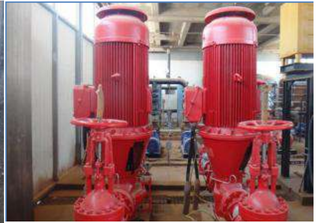
Figure 2.14 :02 Pompes principales (électriques), GA200GA201, de capacité unitaire de 400m 3 /h chacune, à 9.5 at 8.5bars, à démarrage automatique.
