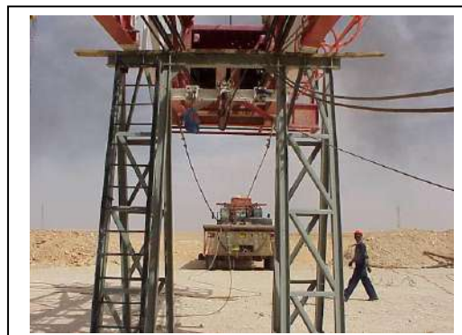
Stand dégagé des lignes
