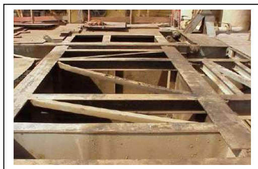
Assurer le ballast des réservoirs
