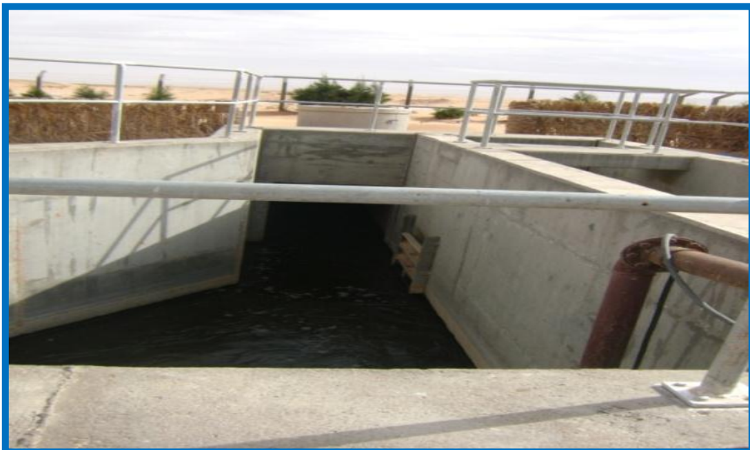
Figure9: sorties des eaux traitées.
