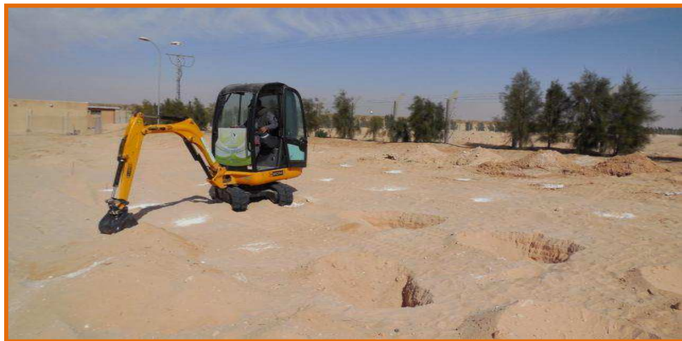
Photo N° 09: Creusement de trous destinés à la plantation à l'aide d'une pelle mécanique.
