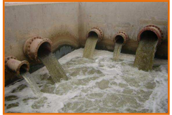
Photo N°03 : Les conduites de l'arrivée de l'eau à la S.T.E.P.
