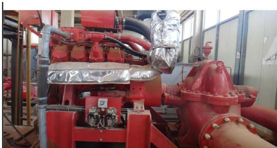
Figure 2.15 :01 Pompe de secours (diesels), GA202, de capacité unitaire de 800m 3 /h démarrage automatiquement, à 07 bars
