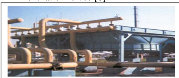
Figure- III-1: aéroréfrigérants installés dans une station de compression de gaz
