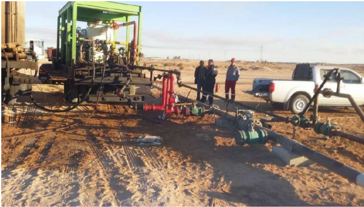
Figure IV-8 installations de Red-Eye et le séparateur sur le puits MD 188
