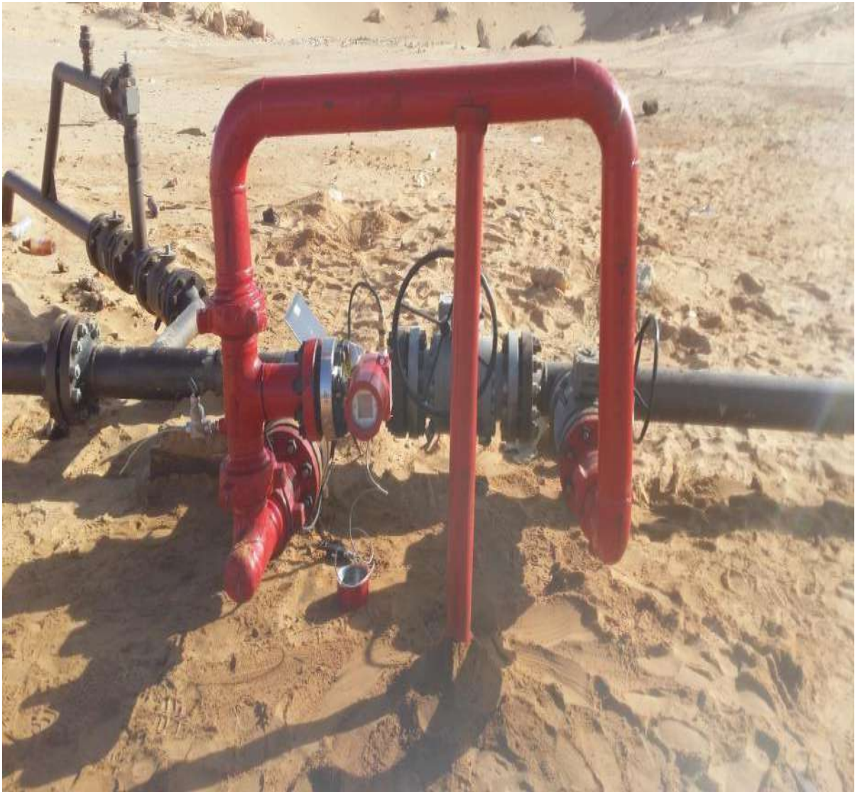
Figure IV-3 installations de Red-Eye sur le puits MD 215
