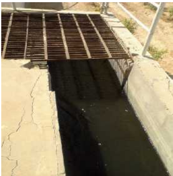
Figure (2) : Canal d'eau usée dans la STEP
