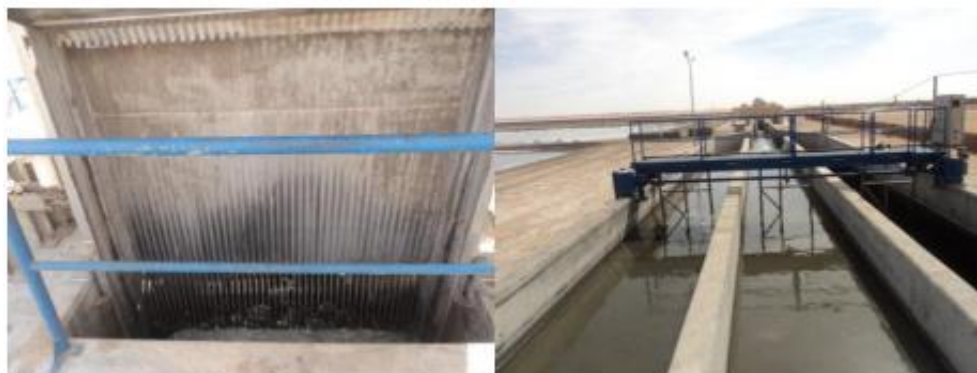
Figure (III-08): Dégrilleur
