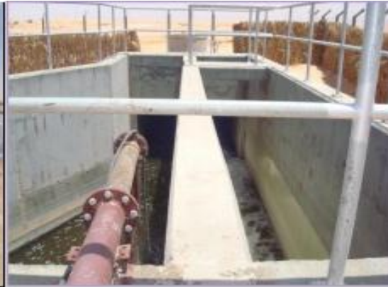
Figure (III-15): la sortie des eaux épurées
