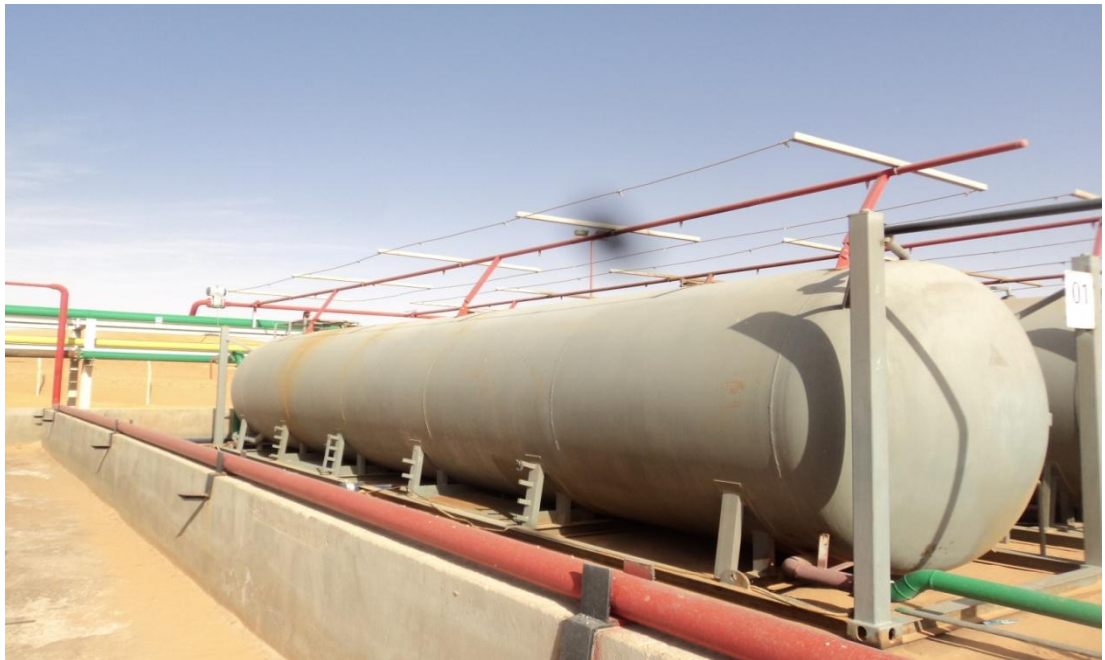
Fig.V.2 :bac de stockage
