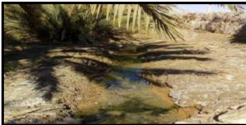
Photo 07 : Etat d'un drain à EX 5 P1
