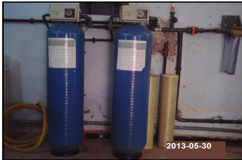
Photo-07 : filtre à charbon actif
