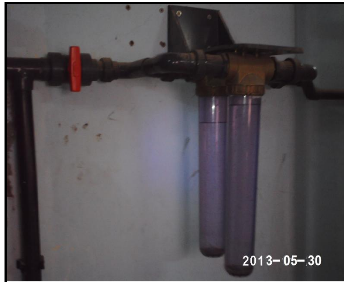
Photo-10 : porte filtre à cartouche
