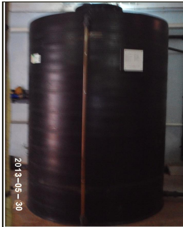
Photo-03 : Cuve d'eau brute 4400L
