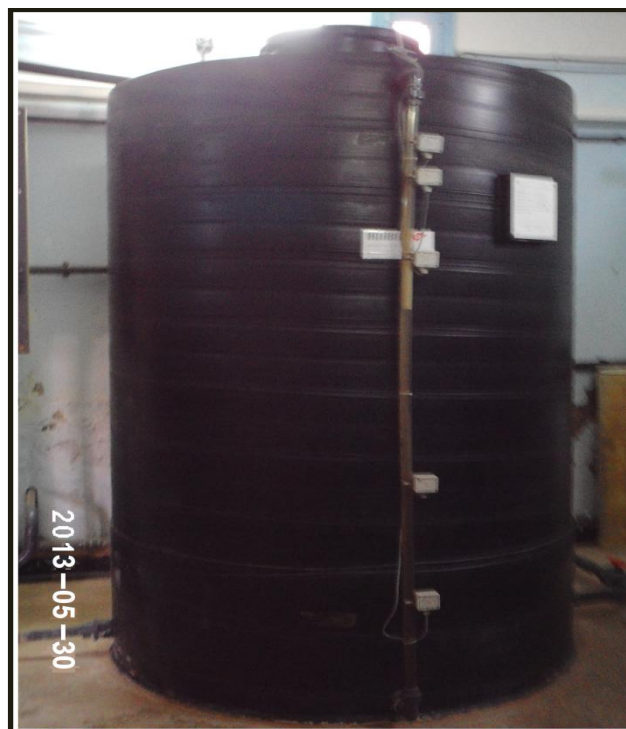
Photo-04: cuve tampon eau ultra-filtrée
