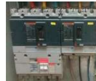
Fig.I.17 : Un disjoncteur général
