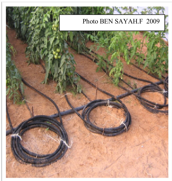
Photo 08: Système de chauffage
