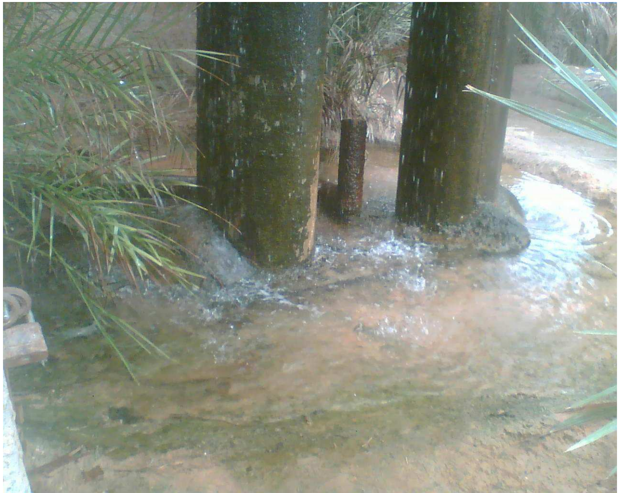
Phot n°01: dégradation des canalisations d'irrigation
