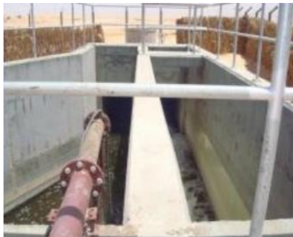
Figure III.12 : Sortie des eaux épurées
