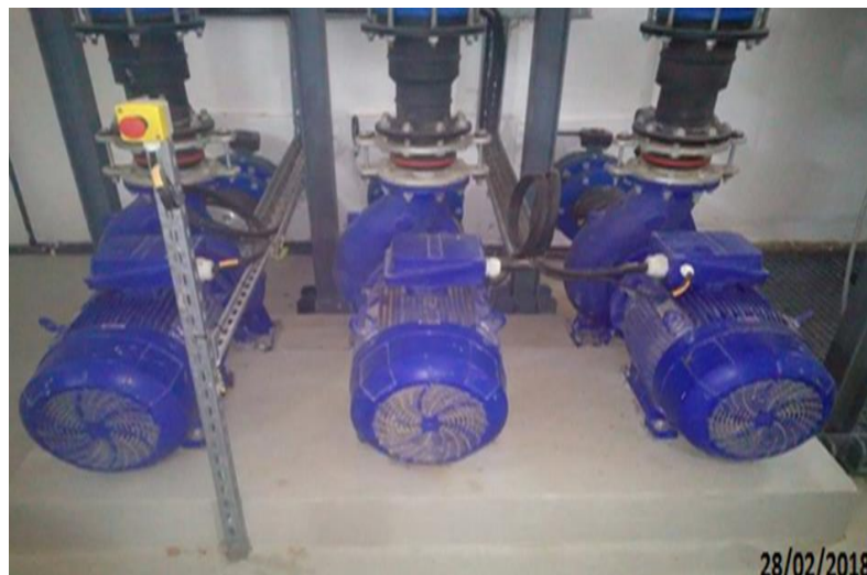
Figure II.4 : Pompes d'alimentation basse pression
