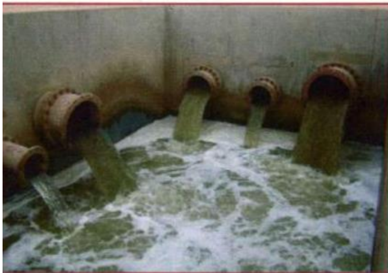
Figure III.3 : Entrée des eaux usées à la station (bassin de dégazage)
