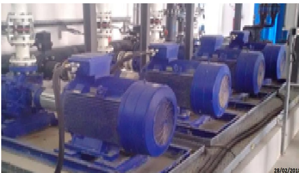
Figure II.7 : Pompes d'alimentation haute pression
