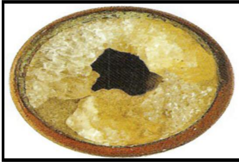
Figure I.3 DEPOT DE SELS (NaCl) DANS UNE CONDUITE DE PRODUCTION.
