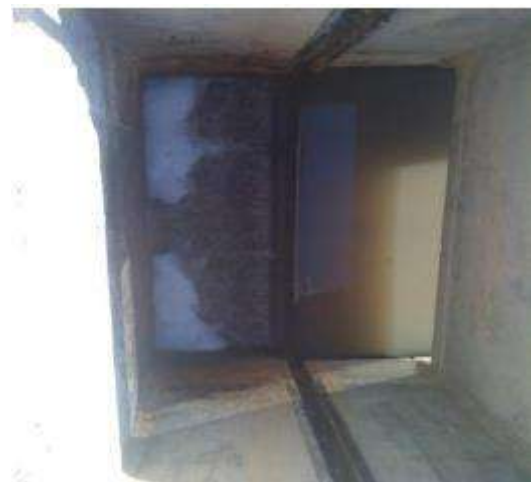
Photo 07: la sortie des eaux épurées [30]
