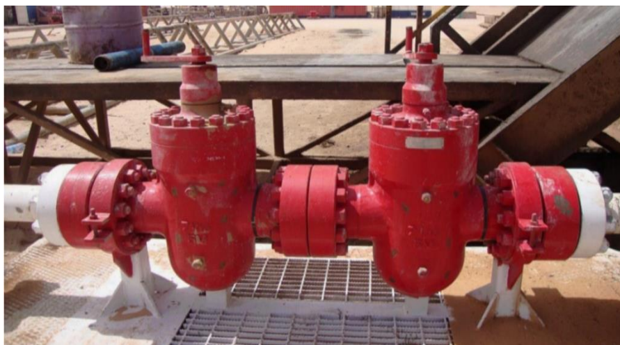
Fig.II.16 : La vanne ESD (manuelle).
