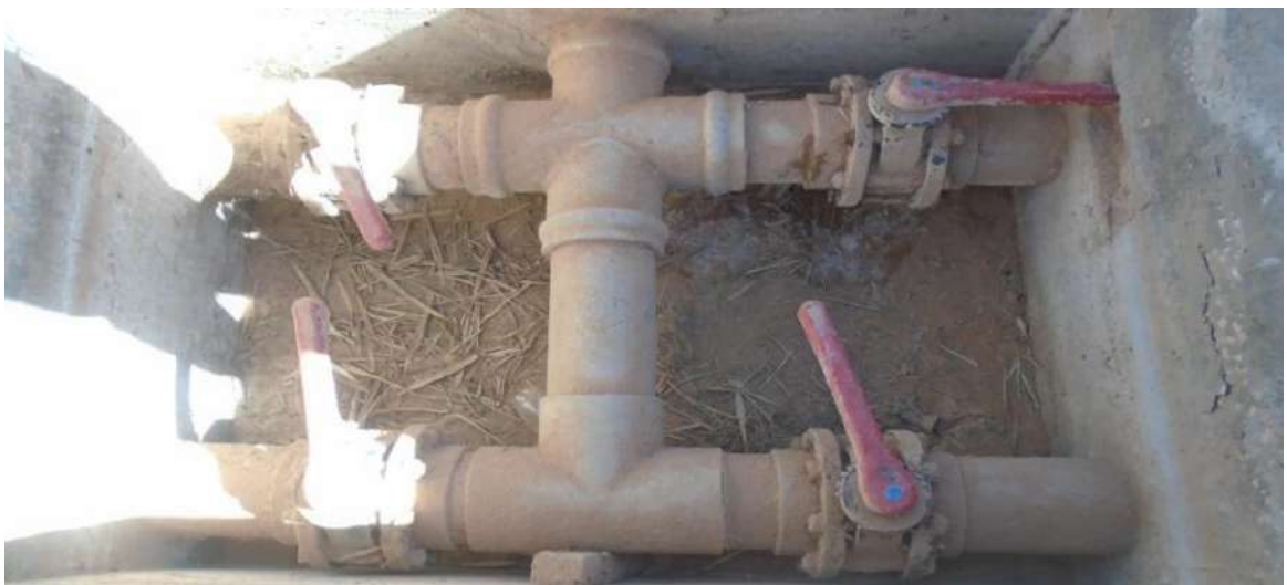
Photo N°(04): Répartiteur
