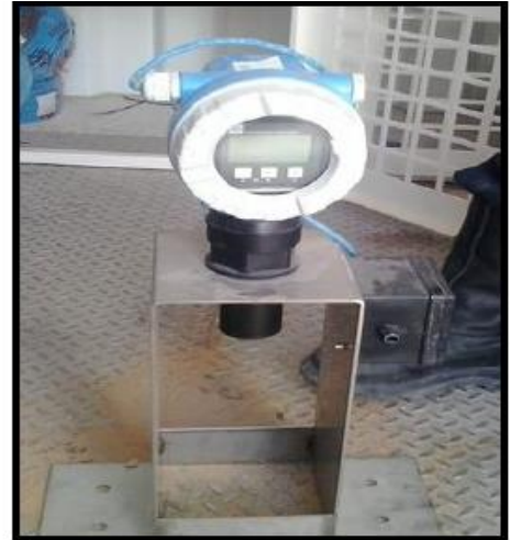
Figure 10 : Capteurs de Niveau des bacs
