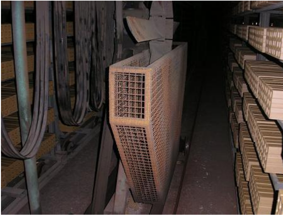
Figure II-4: Ventilateurs destinés au brassage de l'air à l'intérieur du séchoir
