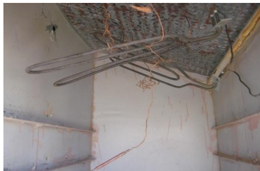
Figure (II.9) : Régulateur résistance électrique avec régulateur de température
