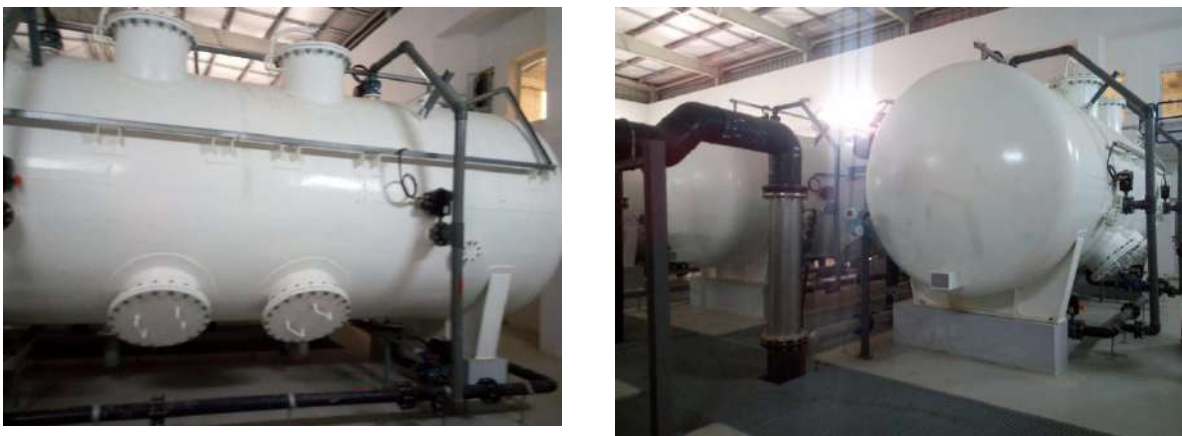
Figure 11 : les filtres à sable de la station d'IFRI GARA.
