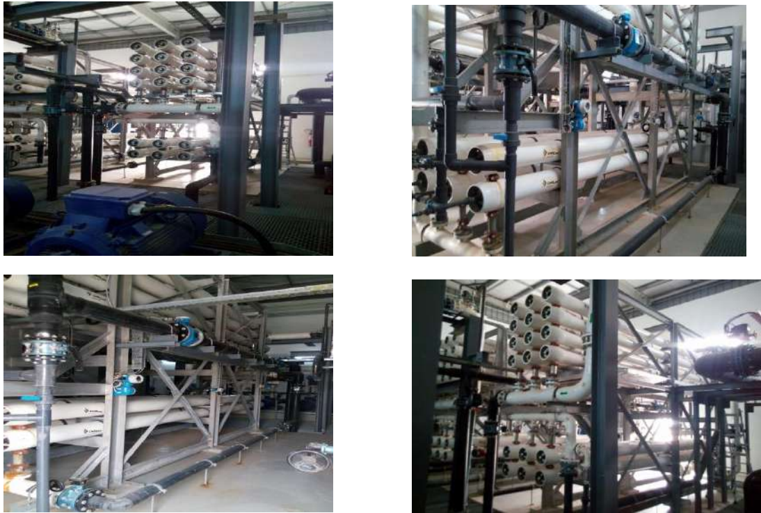
Figure 16: Unité d'osmose et de l'osmose inverse
