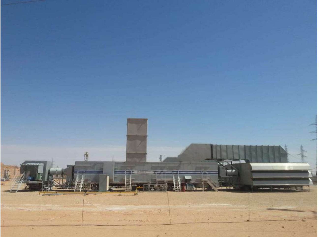
Figure (2-1) : Turbine à gaz FT8 dans centrale mobile d'OUARGLA
