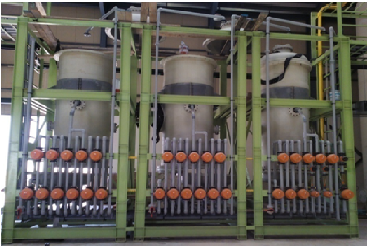
Figure 35. : Filtres à résine
