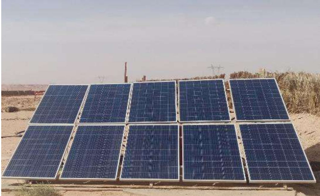
Figure (III.6) : Générateur photovoltaïque de la ferme.
