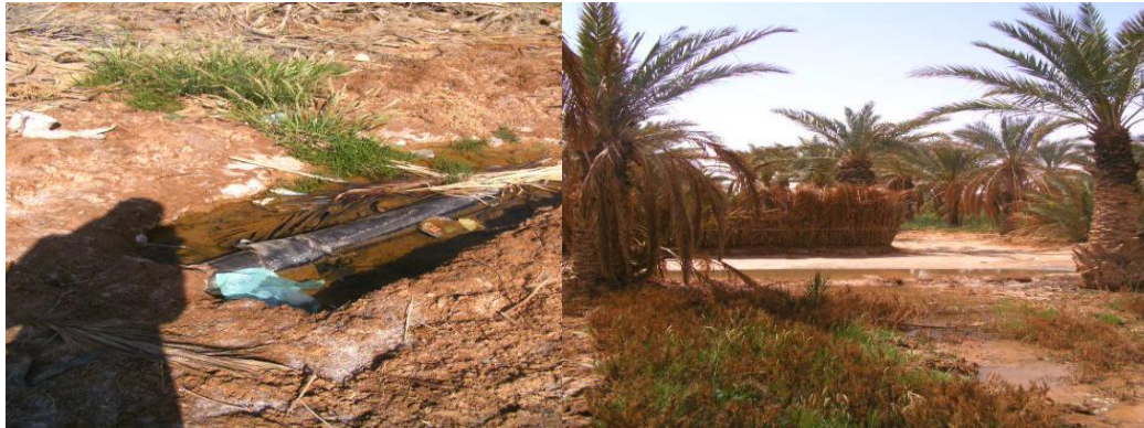
Photo n° 4 : L'état défectueux du réseau d'irrigation et les fuites
