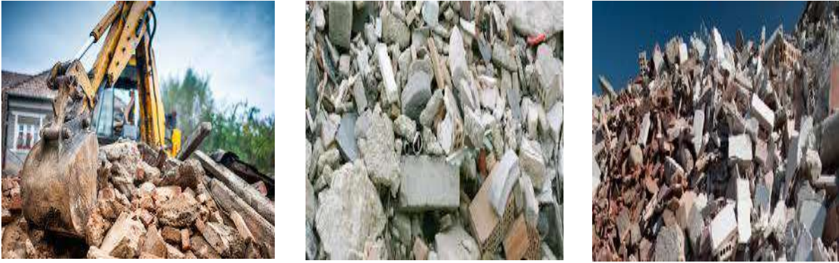
Photo (I.2). Déchets inertes.
