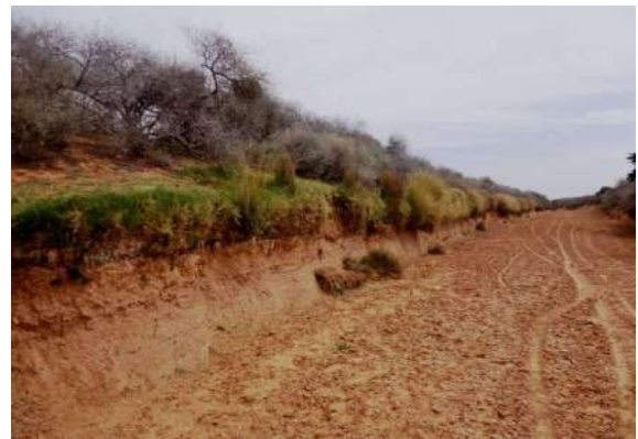
d. Vue générale du lit d'oued Zegrir Encassement du lit mineur dans le site 5
