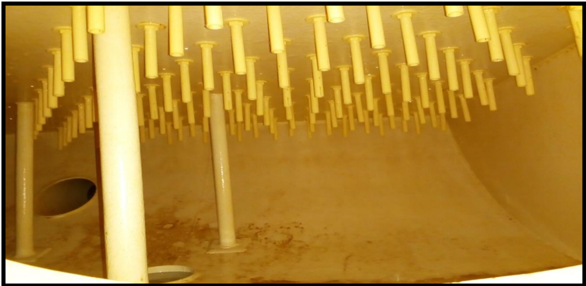
Photo N° 02: Les filtres à sable de la station d'IFRI GARA.
