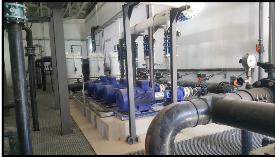
Photo N° 03: Filtres à cartouches de la station d'IFRI GARA.
