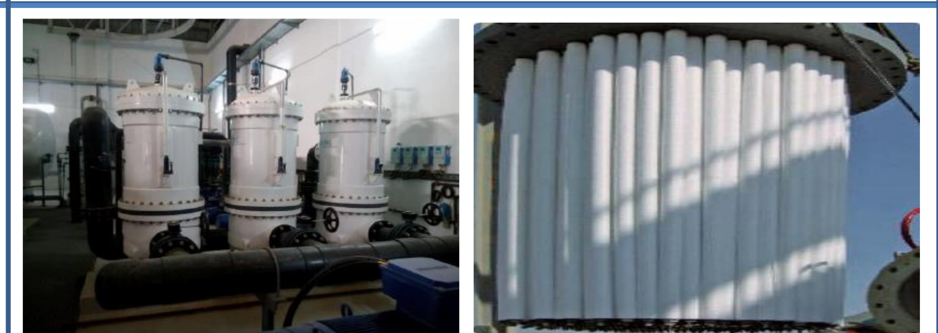
Figure 02: Filtres à cartouches de la station d'IFRI GARA.
