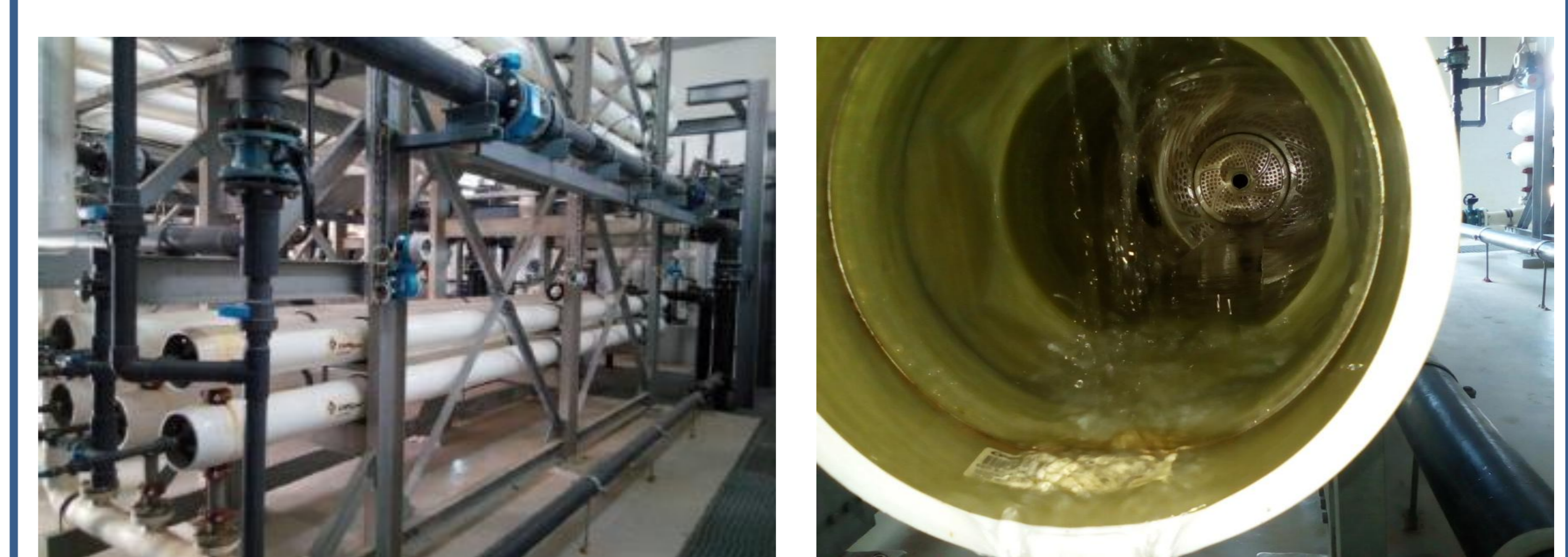
Figure 03: Unité d'osmose et de l'osmose inverse.
