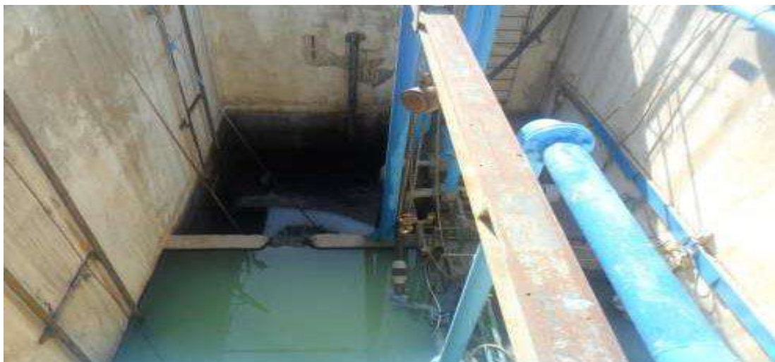
Figure IV.1 : Bassin de collecte des eaux usées industrielles
