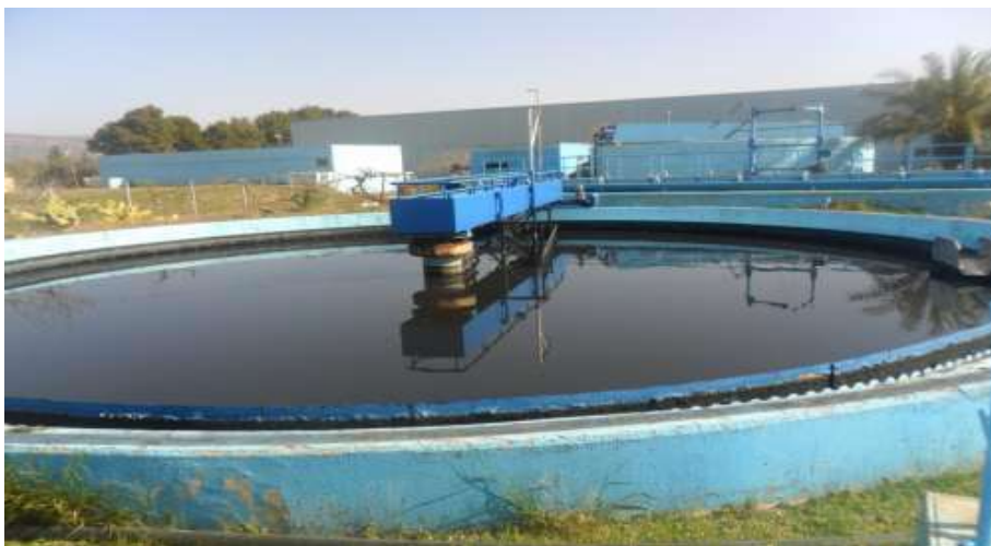
Figure IV.7 : bassin de clarification finale
