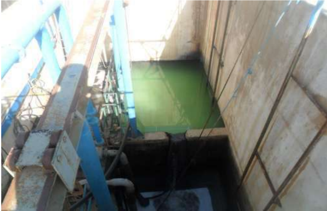
Figure IV.2 bassin de collecte des eaux usées sanitaires
