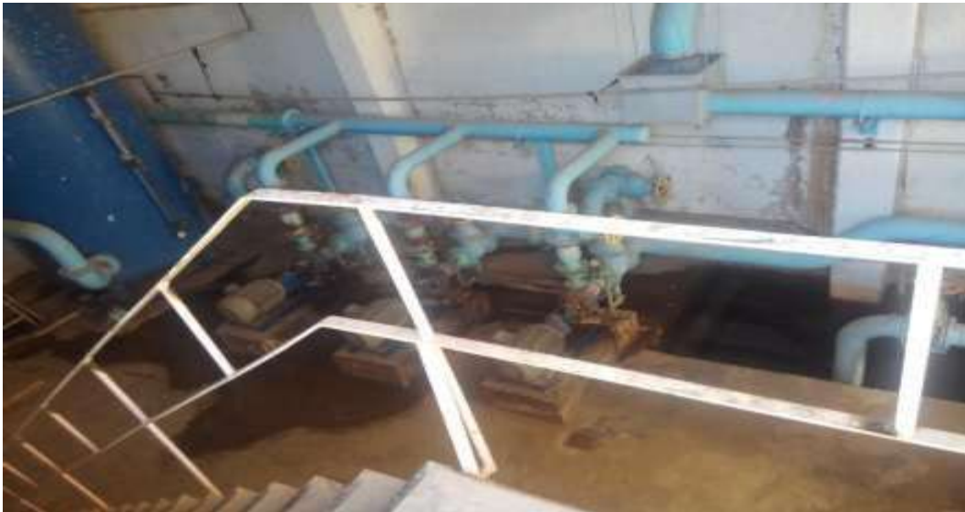
Figure IV.8 : Photo de la station de recyclage de boues
